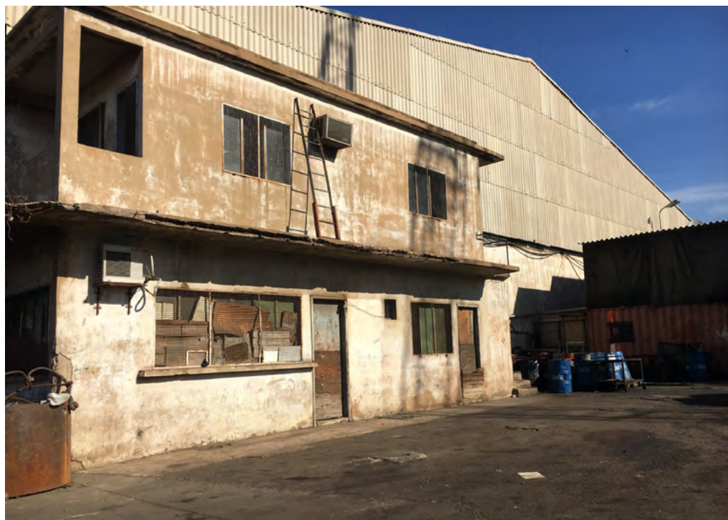
Fig. 5. Magazzini deteriorati, porto del Libano (foto di Hanadi Samhan, settembre 2017).
