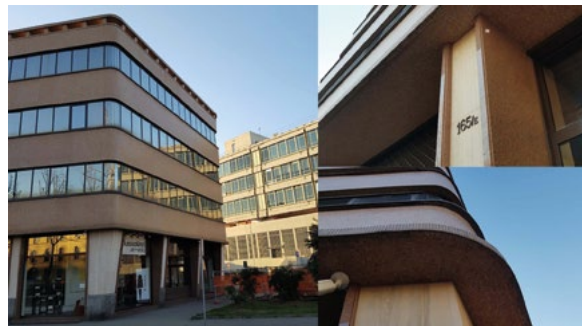
Fig. 5. Stabilimento industriale ex-manifattura maglierie Torino in corso Svizzera angolo via Pessinetto costruito tra il 1953 e il 1962 su progetto dell'arch. Nino Rosani, nell'attuale contesto urbano e dettagli che ne descrivono lo stato di conservazione e i materiali di finitura ancora in opera (foto dell'autrice, 2022).
